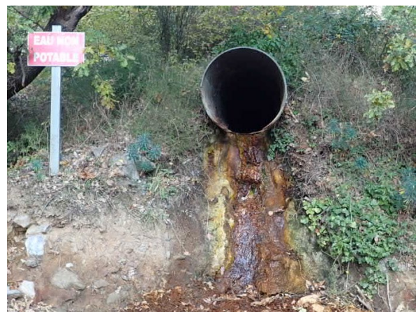
Illustration 35 : Canalisation corrodée, précipités ferrugineux en partie basse
