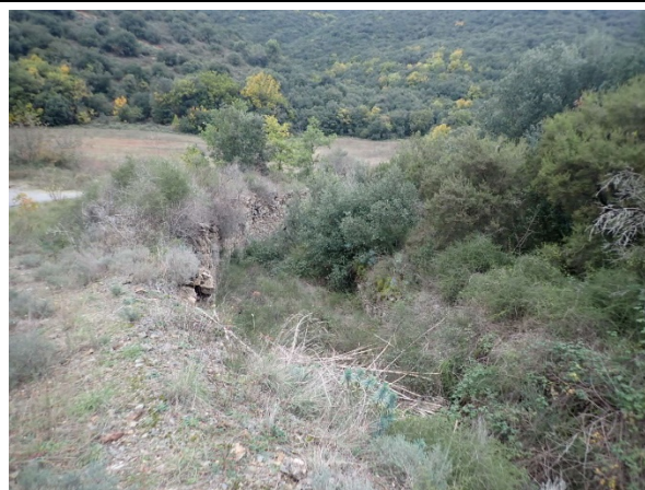
Illustration 31 : Canal d'évacuation de l'Hort-Estiou encombré par la végétation
