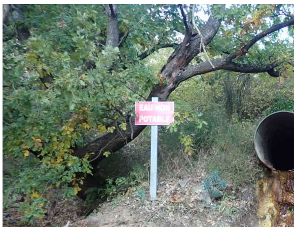
Illustration 34 : Panneau avertisseur au droit de la canalisation, désencombré
